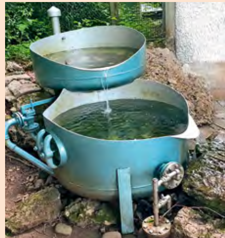
Kesselkaskade vor Wasserverband
